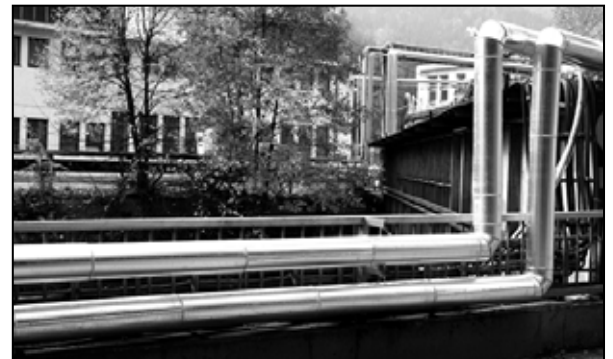
Novovybudované potrubie využitia „odpadného“ tepla z výmenníkovej stanice odprášeného oceliarnie. F. I. Kardhordová
