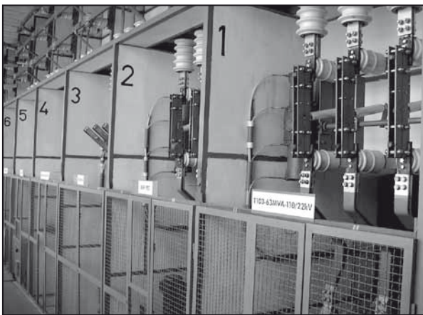
Kontrola vnútorného elektrického zariadenia: 22 kV rozvodňa vstupnej rozvodne starého závodu
