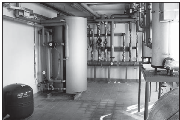
Odovzdávacia stanica tepla ubytovacieho zariadenia na Piesku
